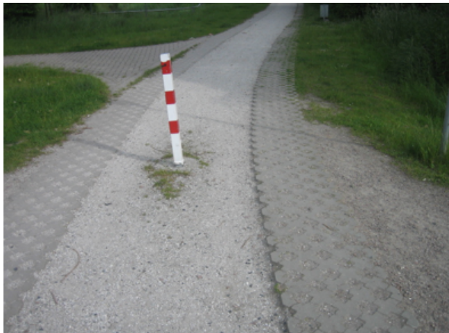
Abbildung 96: Längskante an einem Weg mit wassergebundener Decke
